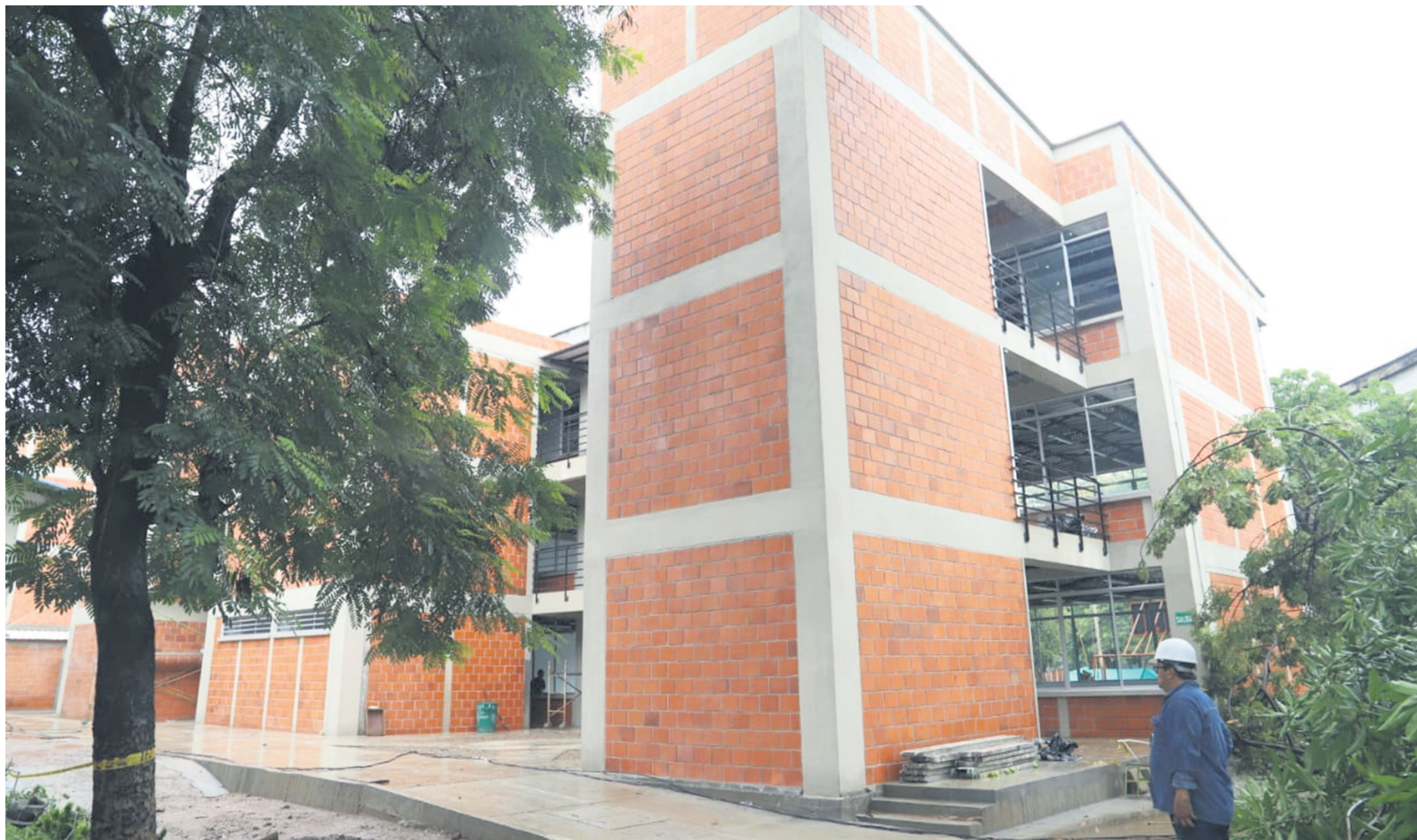
Así avanzan las obras de la Institución Educativa Técnico Superior en la ciudad de Neiva. Uno de los proyectos que próximamente será inaugurado.
