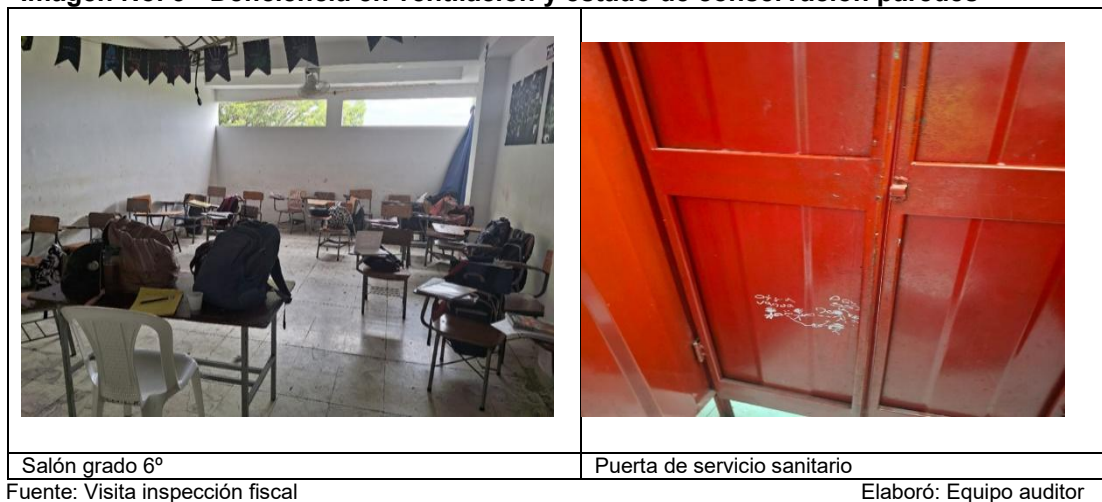
Imagen No. 3 - Deficiencia en ventilación y estado de conservación paredes
