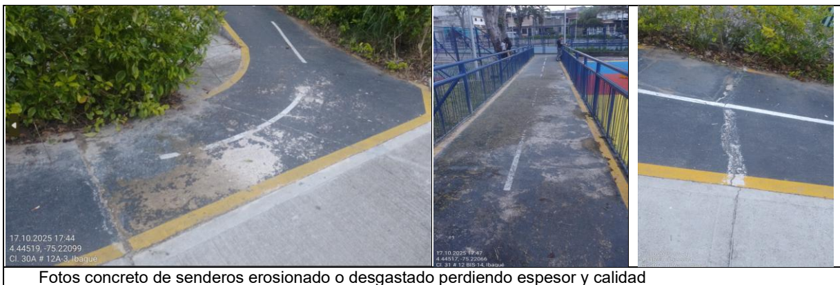
Fotos concreto de senderos erosionado o desgastado perdiendo espesor y calidad
