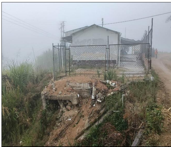
Imagen Área de colapso batería sanitaria
