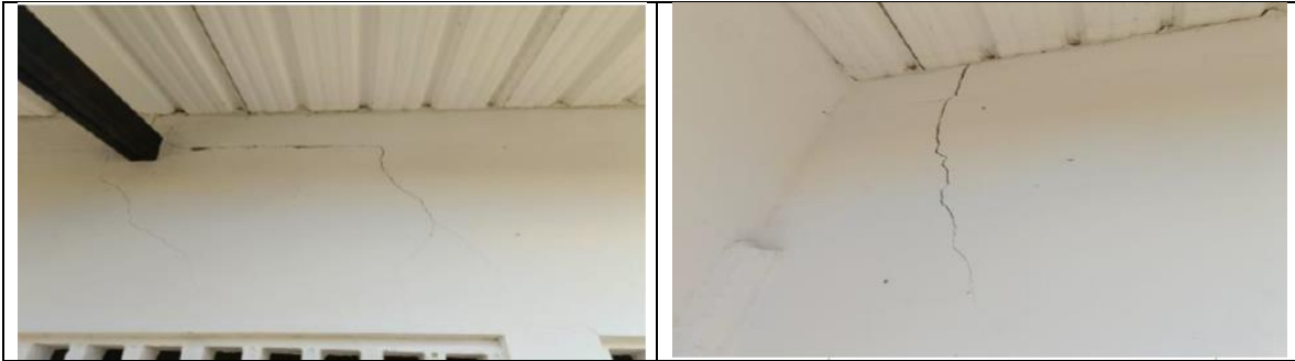
Registro Fotográfico No. 4. Grietas estructurales
