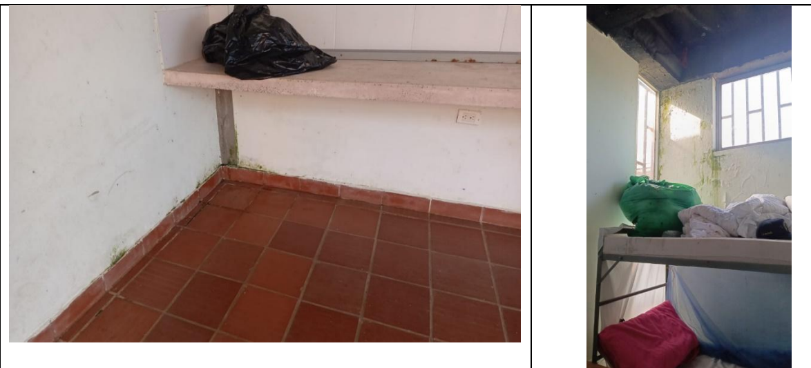
Zona de estar y habitación con presencia de moho en paredes – 17/09/2025
