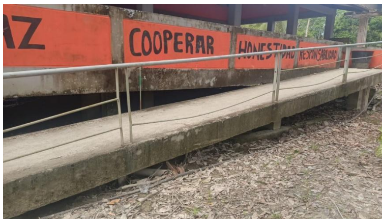
Foto rampa y baranda en mal estado foto visita CGR -19/09/2025
