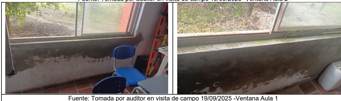
Fuente: Tomada por auditor en visita de campo 19/09/2025 -Ventana Aula 1
