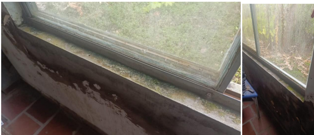
Fuente: Tomada por auditor en visita de campo 19/09/2025 -Ventana Aula 2
