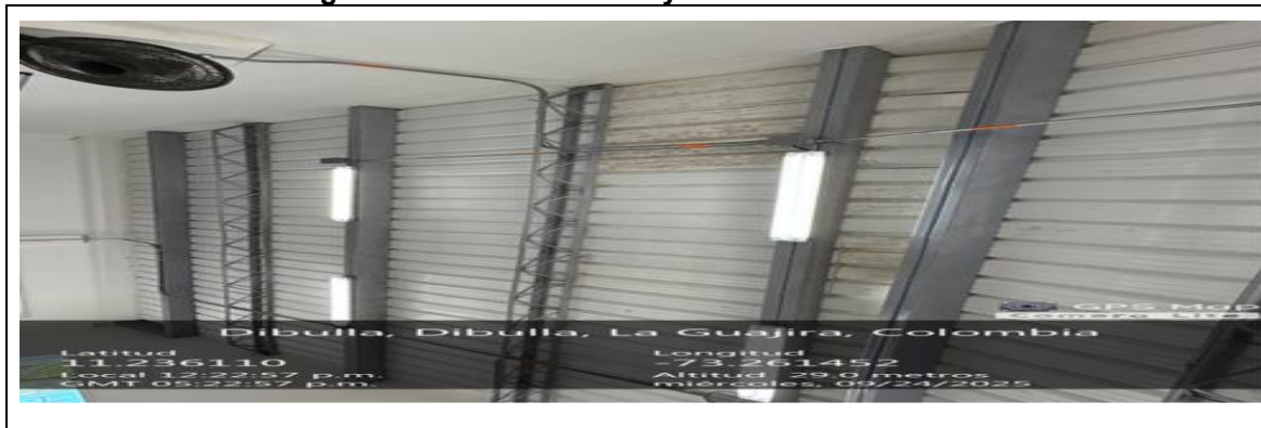
Imagen No. 4 Aula Conduits y Canalizaciones Visibles
