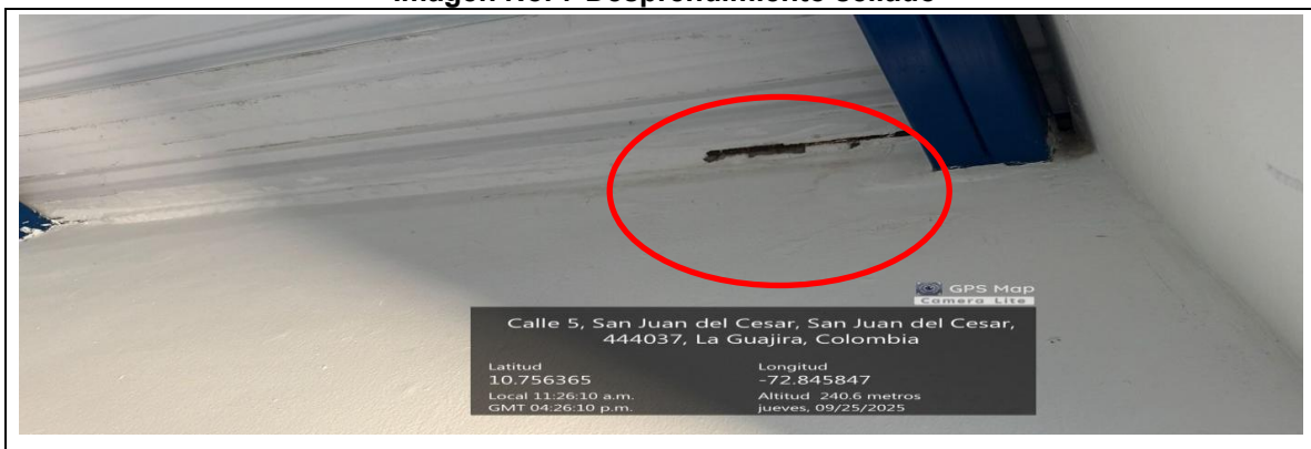
Imagen No. 7 Desprendimiento sellado
