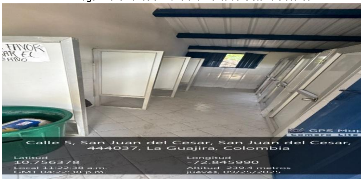
Imagen No. 8 Baños sin funcionamiento del sistema eléctrico
