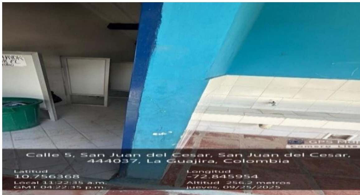
Imagen No. 9 Baños sin funcionamiento del sistema eléctrico
