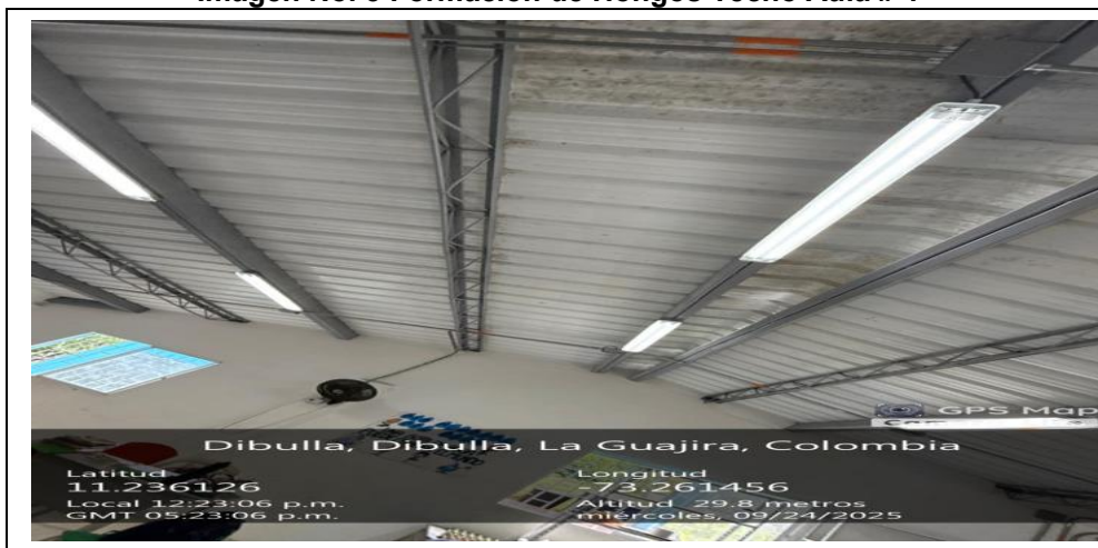
Imagen No. 3 Formación de Hongos Techo Aula # 1
