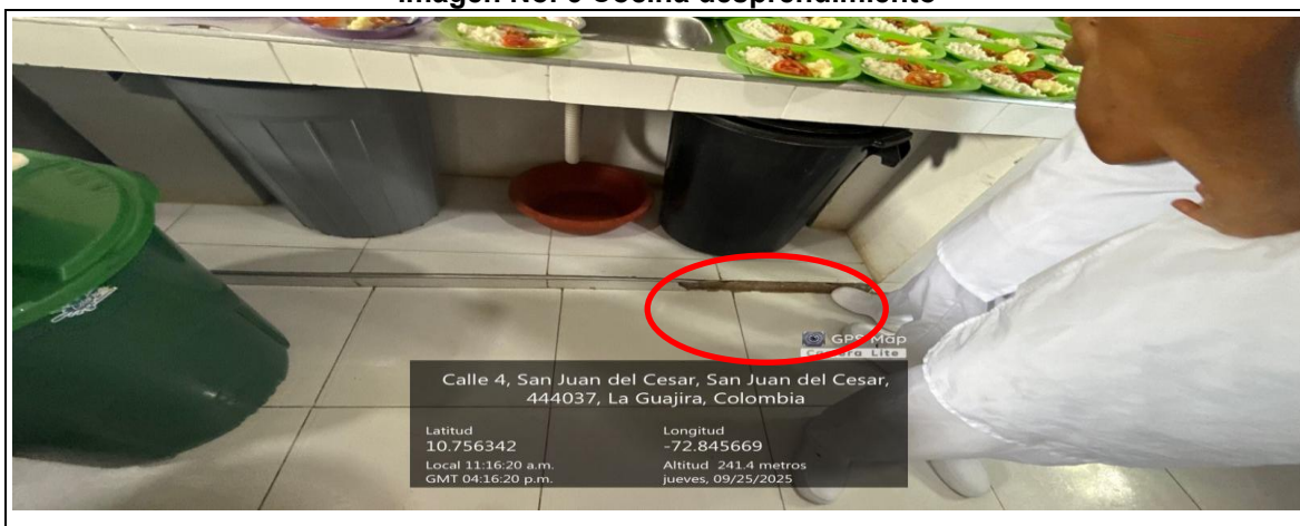
Imagen No. 6 Cocina desprendimiento
