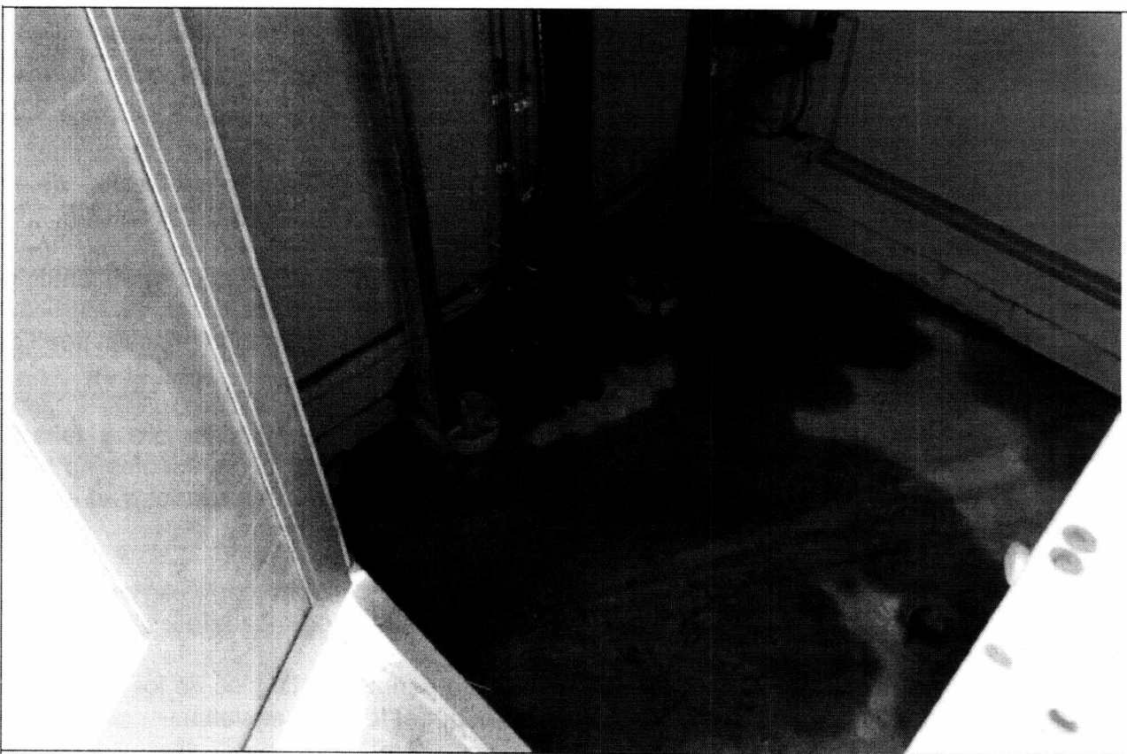
Evidencia de encharcamiento al interior de los fosos del elevador.
