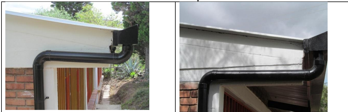
Cuadro No. 46. Registro fotográfico deficiencias en bajantes de aguas lluvias – Sáchica Espinal.
