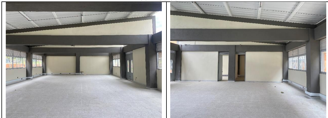
Imagen No. 9. Baldosín instalado, pero no concluido acorde a lo solicitado en el ítem contractual.
