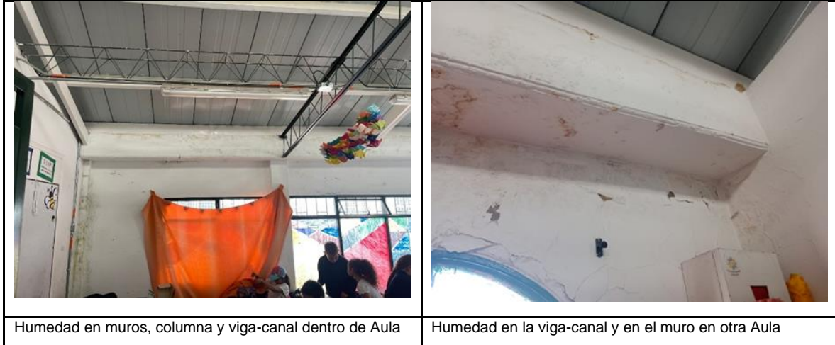
Figura 2. Imágenes de las Humedades al Interior de la IE
