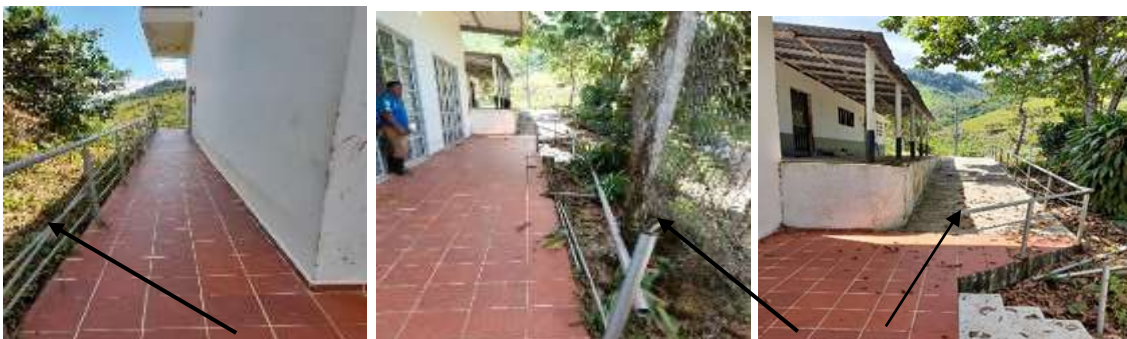
Desprendimiento Tubería de aguas negras Fuente: Visita técnica CGR octubre de 2023
