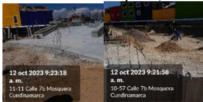
Imagen No. 4. Detalle de la zona en donde falta ejecución, contrato de obra 4 de 2022,
