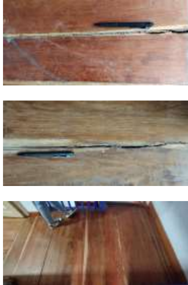
Imagen No. 2. Evidencia del estado de la madera al momento de la visita de la CGR – Casa La Tulipana, Municipio de Fusagasugá
