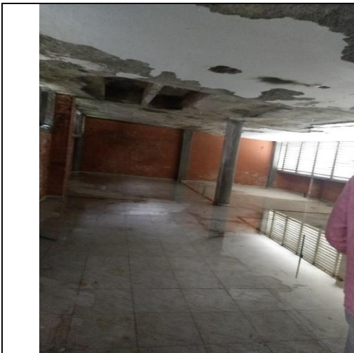
Colegio República de Venezuela, sede Policarpa Salavarieta. Sede completamente abandonada por las condiciones de humedad, filtración. Conforme con información suministrada por las directivas de la IE, la oficina de riesgos Distrital recomendó no utilizar la edificación, sin embargo, no existe un estudio de vulnerabilidad que avale esta recomendación.
