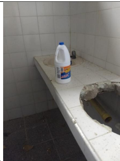
Colegio República de Venezuela, sede Policarpa Salavarieta. Batería sanitaria que ha sido vandalizada por el abandono de la edificación.
