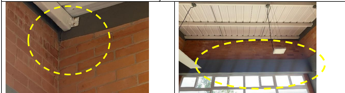
Foto 172 Fisura y humedad en laboratorio
