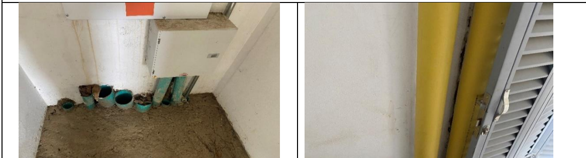
Foto 169 Deficiencias en instalación de tuberías
