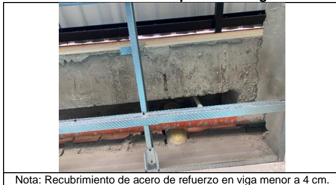
Foto 55 Acero expuesto en viga
