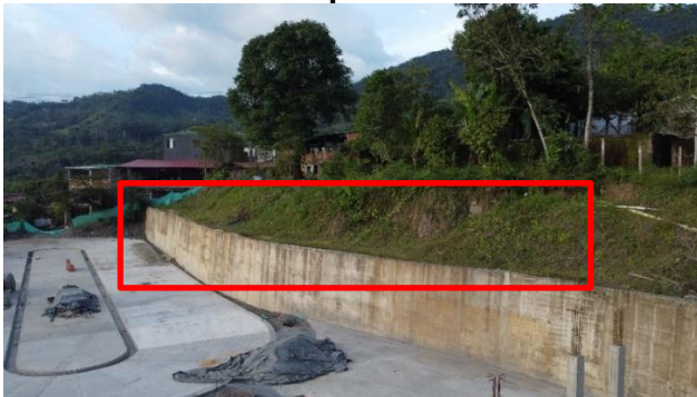
Foto 1 zona de relleno de pared de muro de contención
