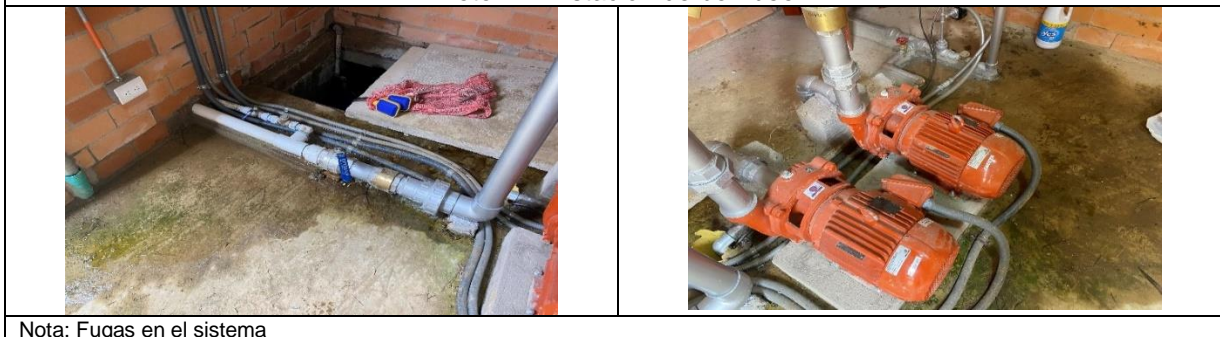
Foto 171 Estación de bombeo
