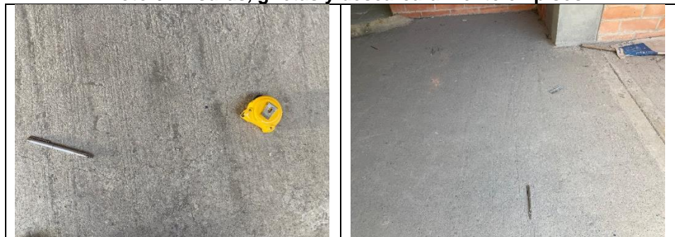
Foto 62 Fisuras, grietas y descascaramiento en pisos
