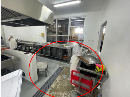
Pintura está cuarteada- piso de cocina.
