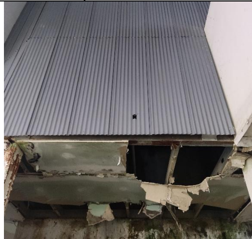
Cielo raso descolgado en láminas de Dry Wall
