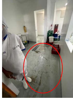
Pintura está cuarteada- piso de cocina.
