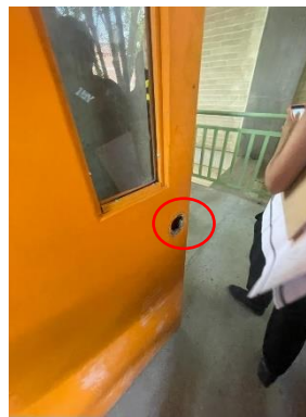
Ausencia de chapa
