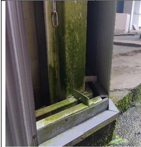
Detalle estado estructura metálica
