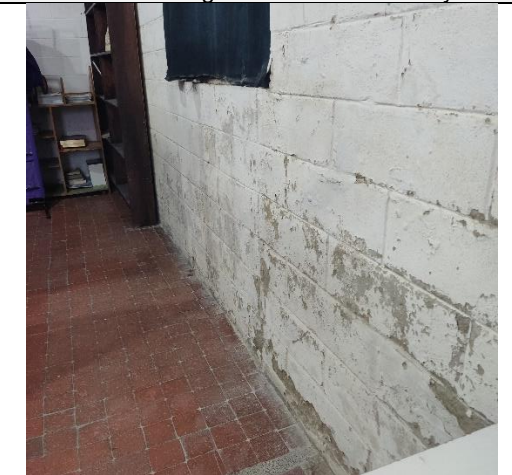
Afectaciones en la Casa de La Cultura por húmedades
