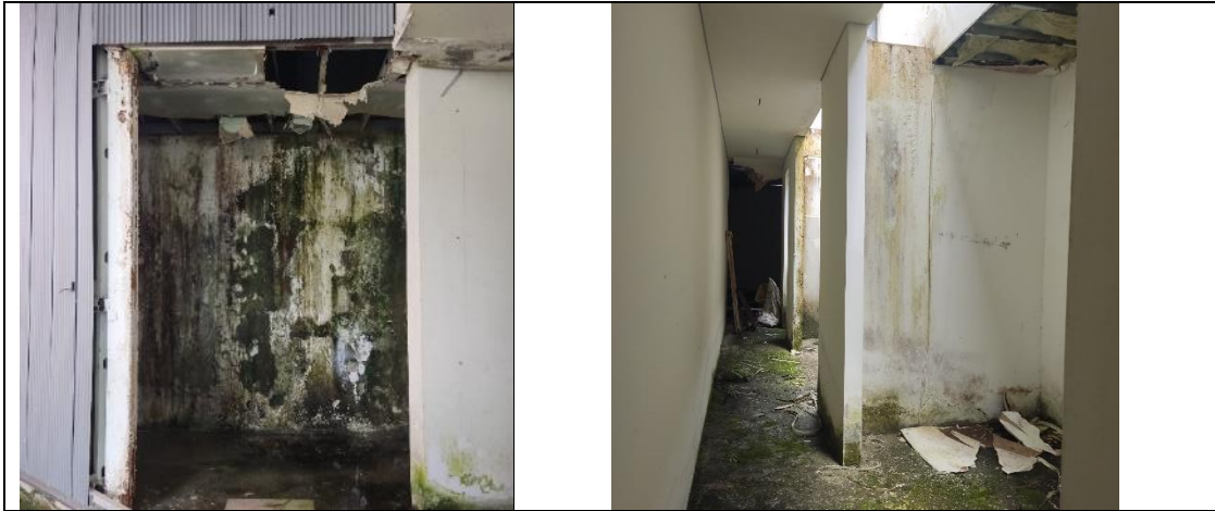
Muros en Superboard afectados por humedades y crecimiento de moho
