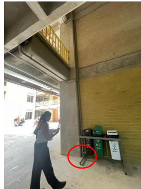
Tubería desagüe sin conexión
