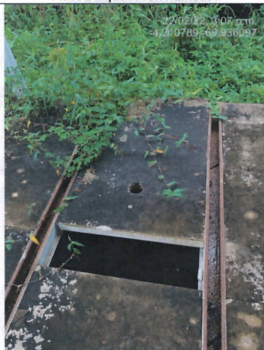
Panel tipo sándwich con humedad
