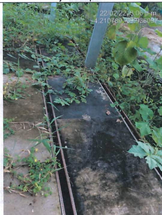
Humedad en panel tipo sándwich
