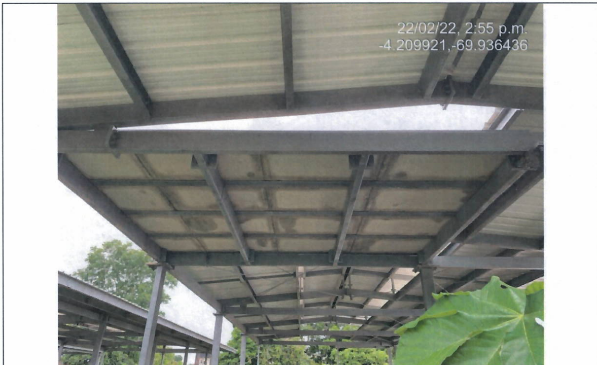
Humedad en panel tipo sándwich cubierta
