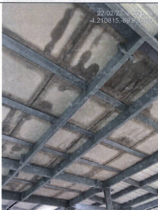
Humedad en cubierta panel tipo sándwich
