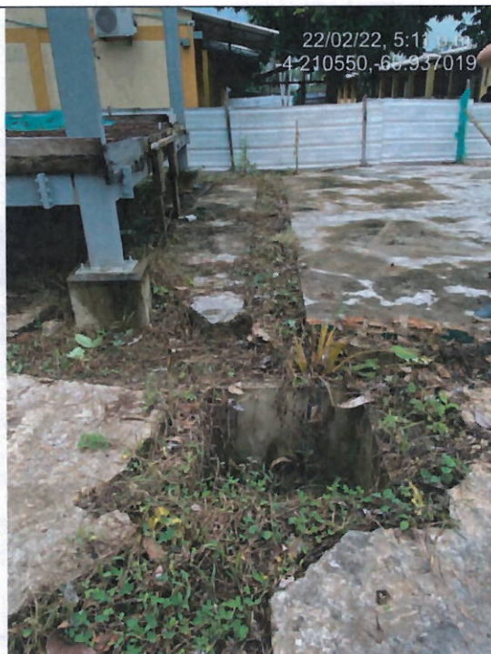
Caja de inspección
