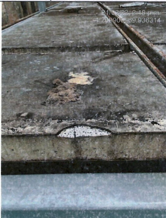
Panel tipo sándwich con humedad
