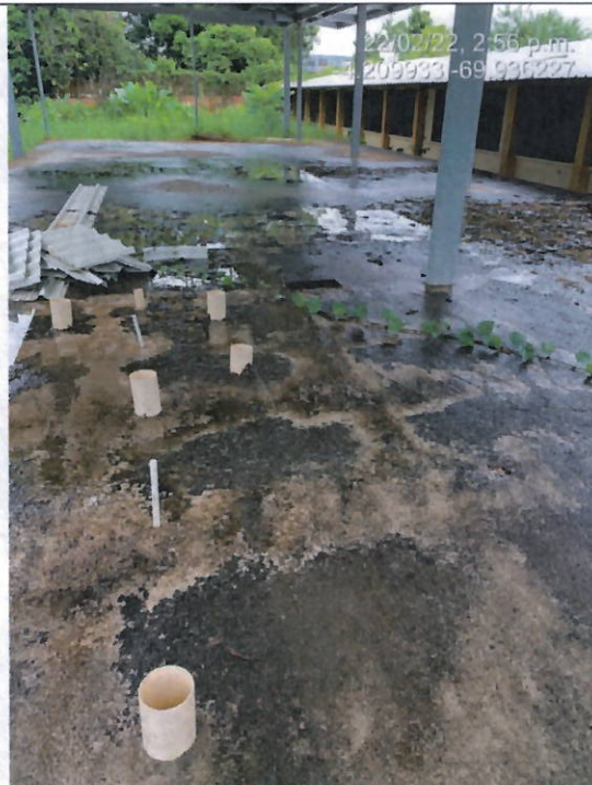
Placa Bloque A con humedad
