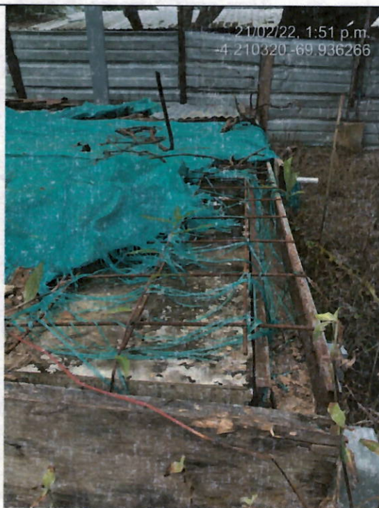
Malla electrosoldada oxidada
