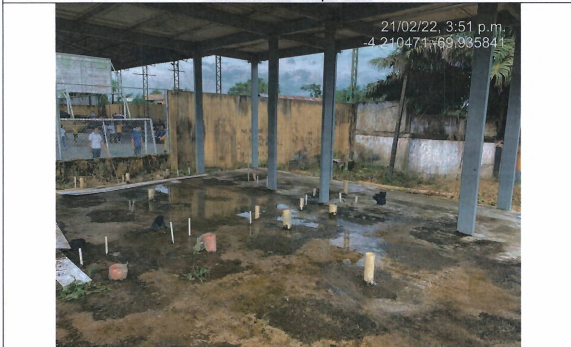
Placa Baños Bloque G
