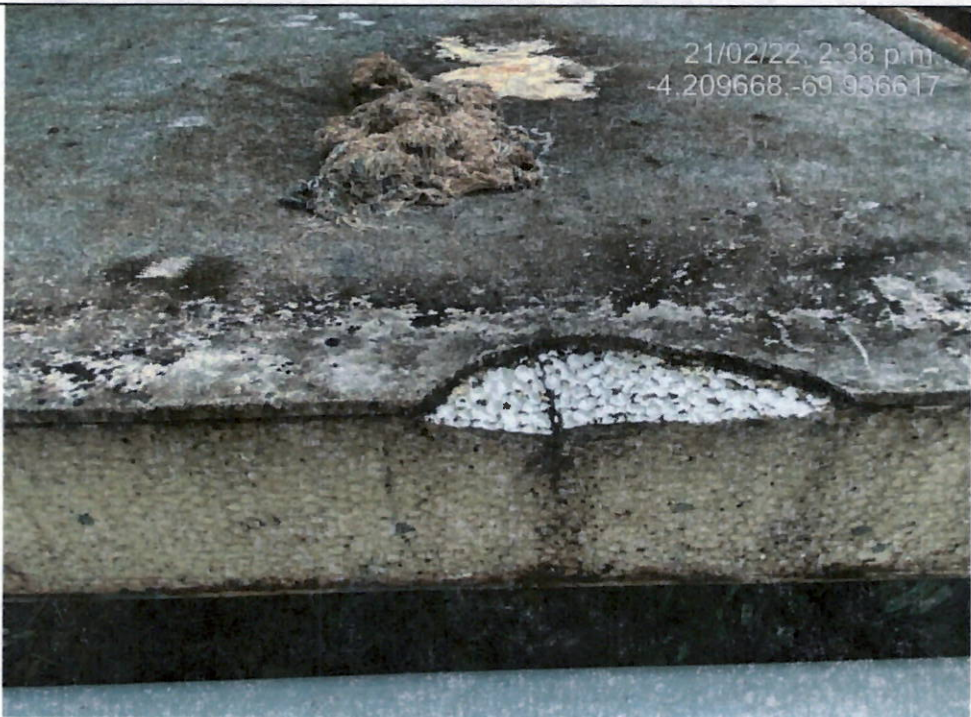
Panel tipo sándwich con humedad
