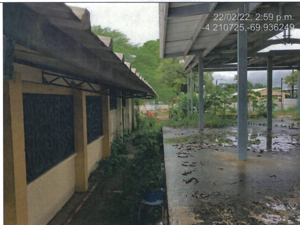
Placa Bloque A con humedad
