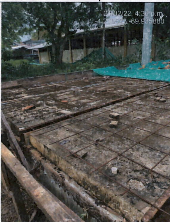
Malla electrosoldada oxidada
