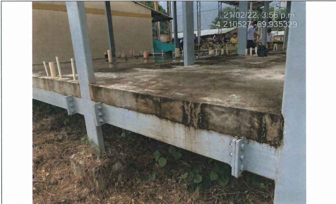
Placa Baños Bloque G
