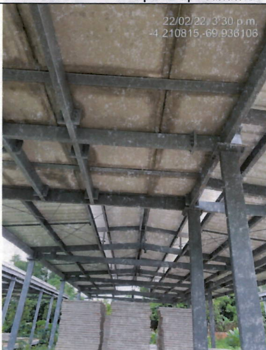
Humedad en cubierta panel tipo sándwich
