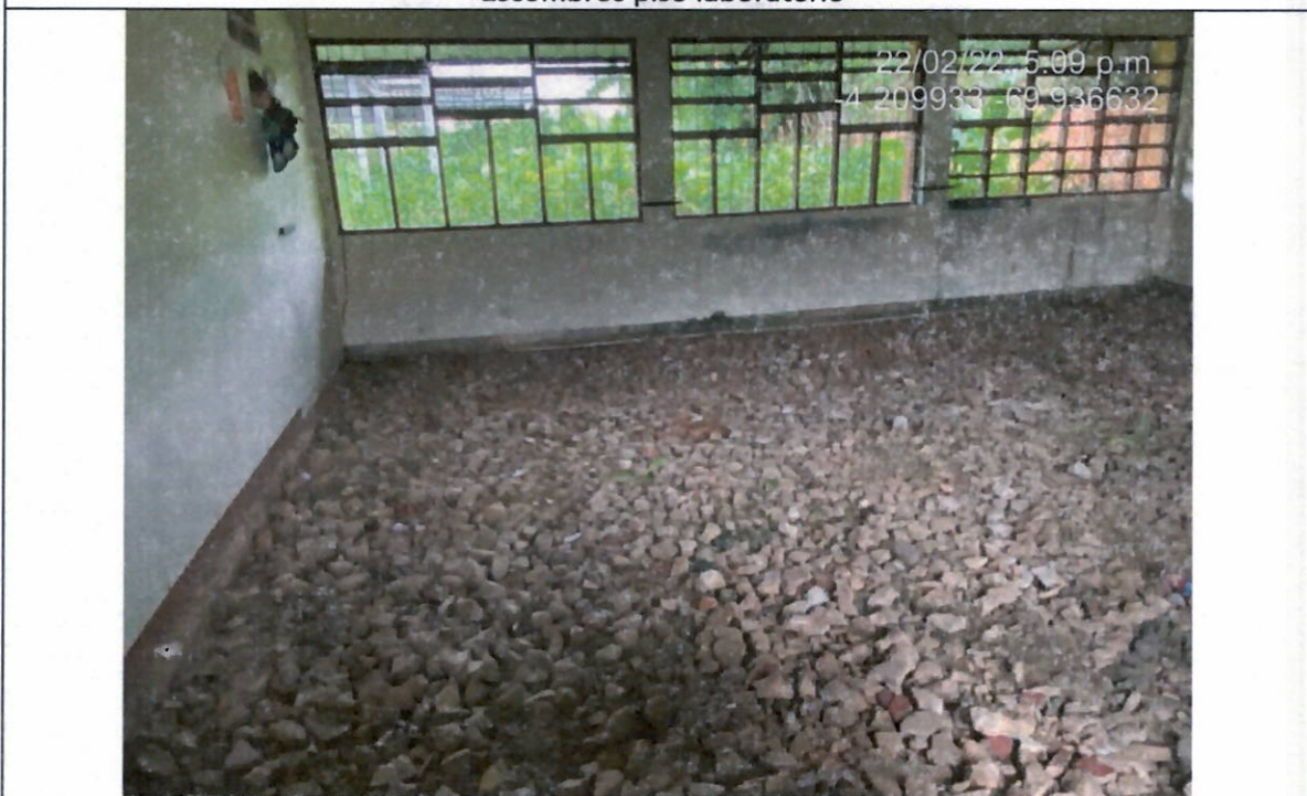
Escombros piso laboratorio
