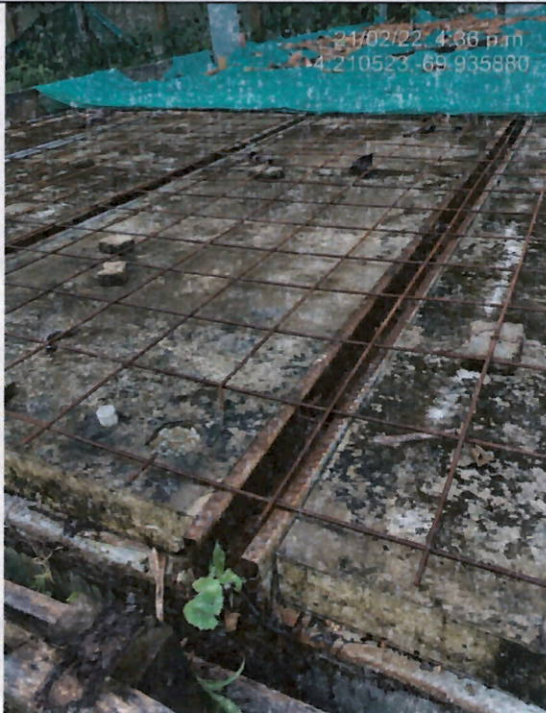
Malla electrosoldada oxidada
