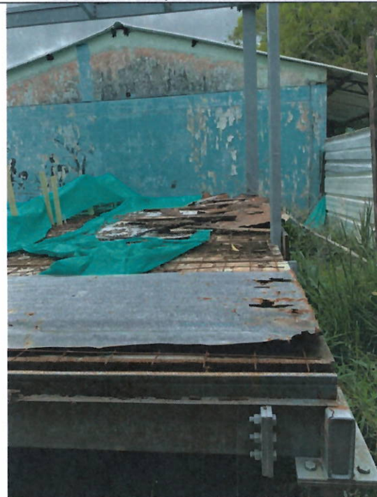
Malla electrosoldada oxidada
