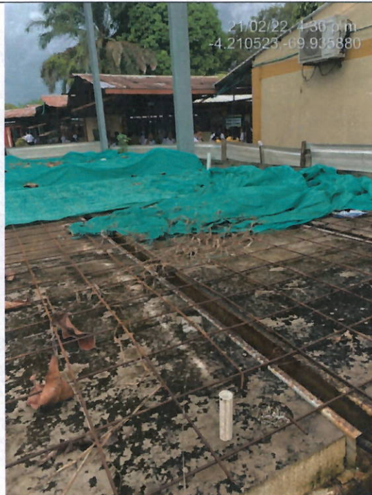
Malla electrosoldada oxidada
