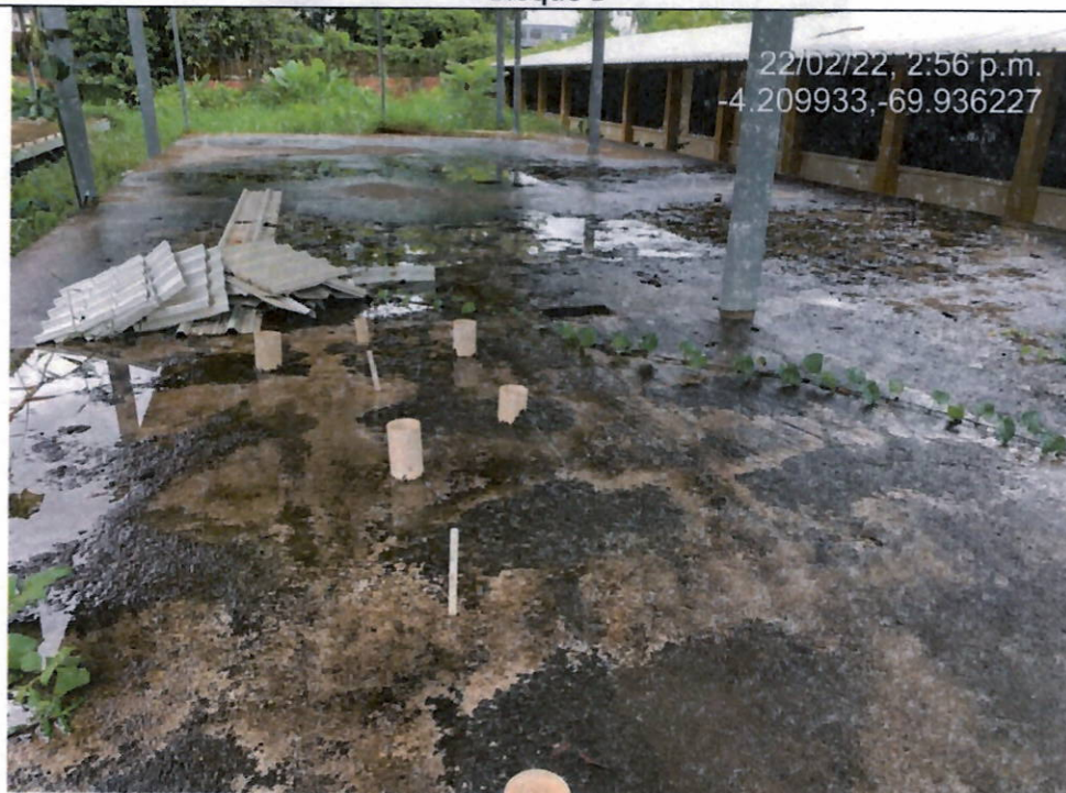
Humedad Placa Bloque A
