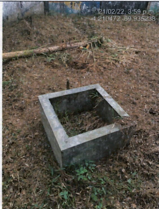
Caja de inspección
