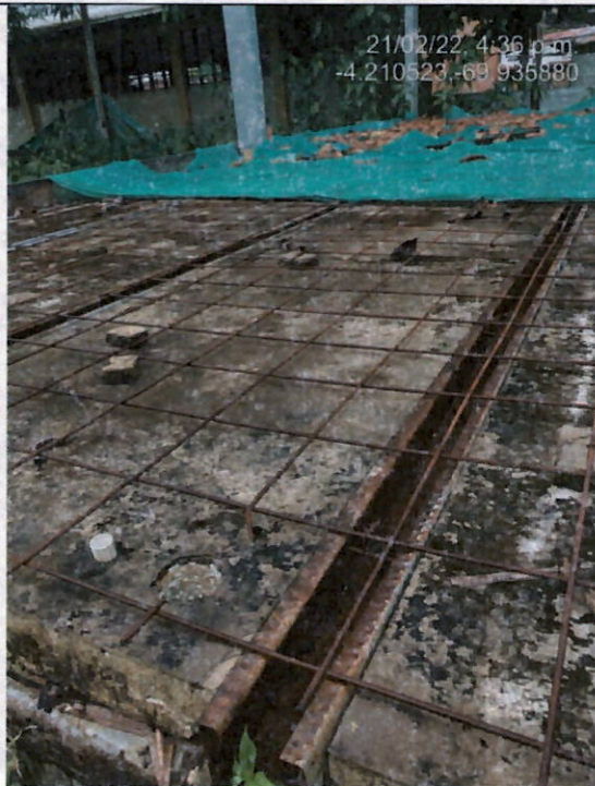
Malla electrosoldada oxidada
