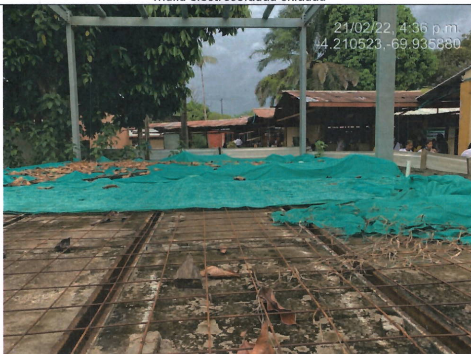
Malla electrosoldada oxidada
