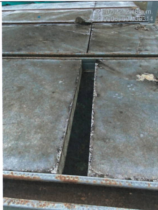
Panel tipo sándwich con humedad
