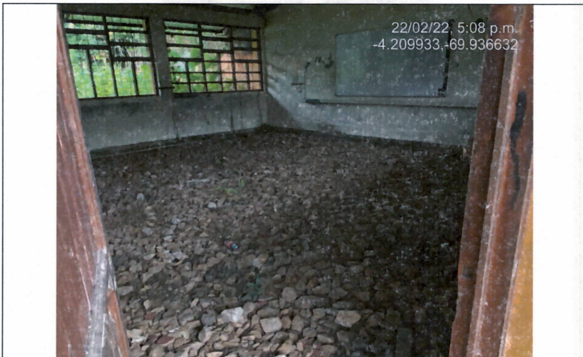
Escombros piso laboratorio
