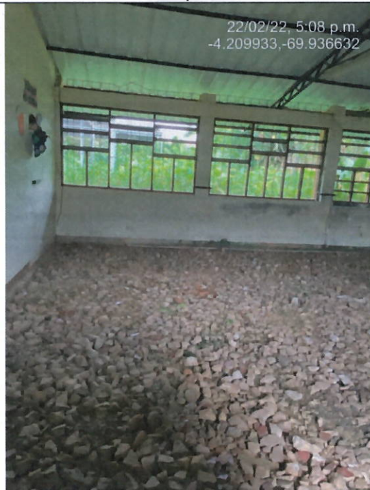
Escombros piso laboratorio
