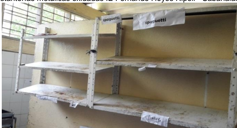
Foto No. 39. Esteras metálicas oxidadas IE Fernando Hoyos Ripoll - Sabanalarga
