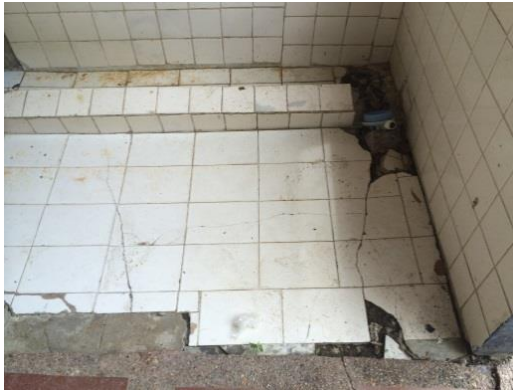
Pisos en mal estado
