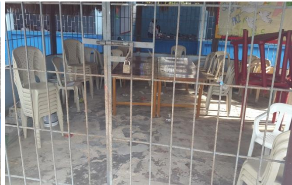
Pisos del comedor deteriorados
