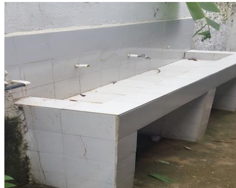
Foto No. 73. Lavamanos fuera de servicio
