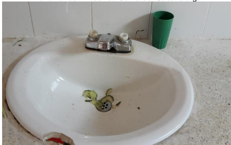
Foto No. 37. Lavamanos IE Técnica Comercial Sabanalarga
