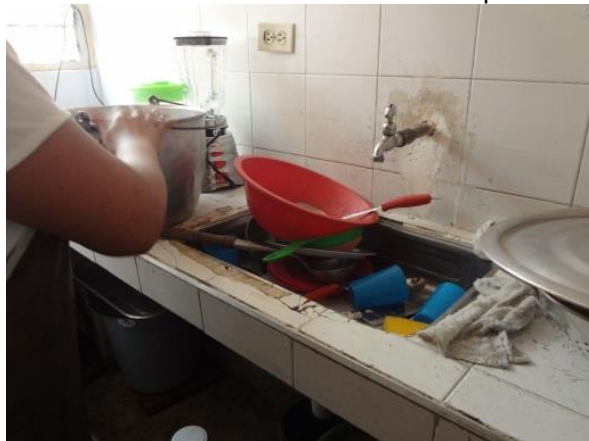
Foto No. 113. Mesón de la cocina deteriorado. IE Loperena
