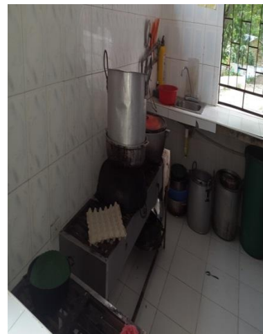
Estufas en mal estado
