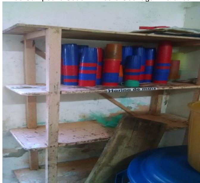
Foto No. 46. Estantes en mal estado en cocina de la IE Técnica Agropecuaria de Campeche Sede 2- Pedro Goenaga - Baranoa
