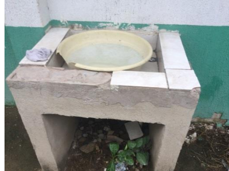
Foto No. 71. Sitio adaptado como lavamanos
