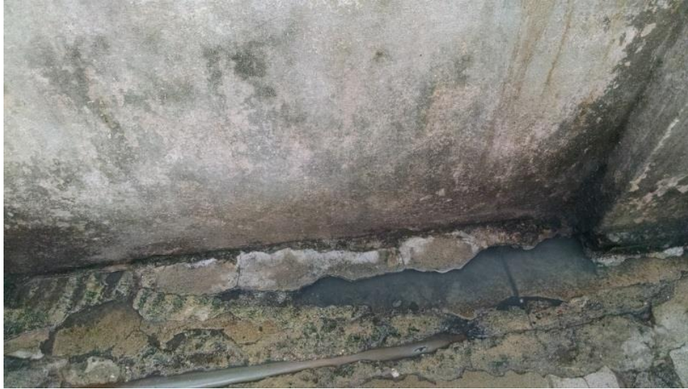
Foto No. 45. Agua empozada afuera de la cocina en la Sede 2- Pedro Goenaga IE Técnica Agropecuaria de Campeche - Baranoa
